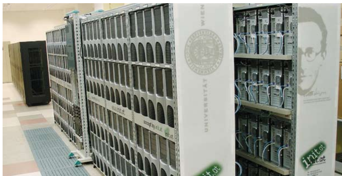
„Schrödinger III“ ist der derzeit schnellste Supercomputer in Österreich. 240 Rechner erreichen nicht weniger als 1,14 Billionen Rechenoperationen pro Sekunde. Foto: init.at
