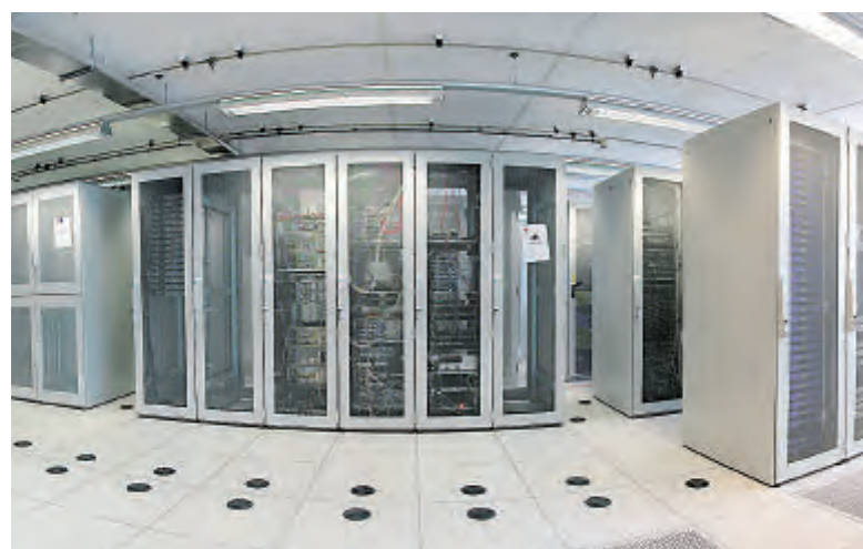
Nicht nur die Server selbst, auch die Räume, in denen diese untergebracht sind, müssen geschützt werden. Foto: Fotolia.com
